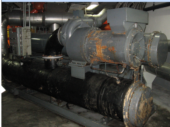
Centrífuga onde foi realizado o Retrofit com o ISCEON™ 39TC.
