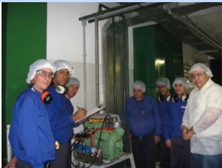
Substituição do R-12 pelo ISCEON™ MO49 em um túnel de refrigeração.
